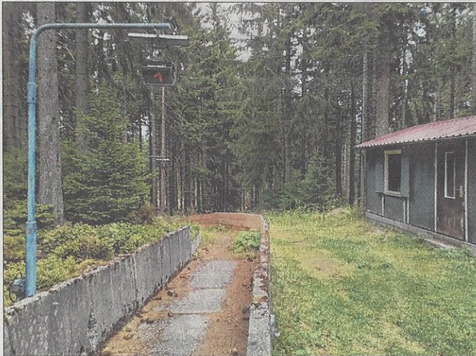
Bröckelnder Beton am Start der Rodelbahn am Barenberg bei Schierke.
